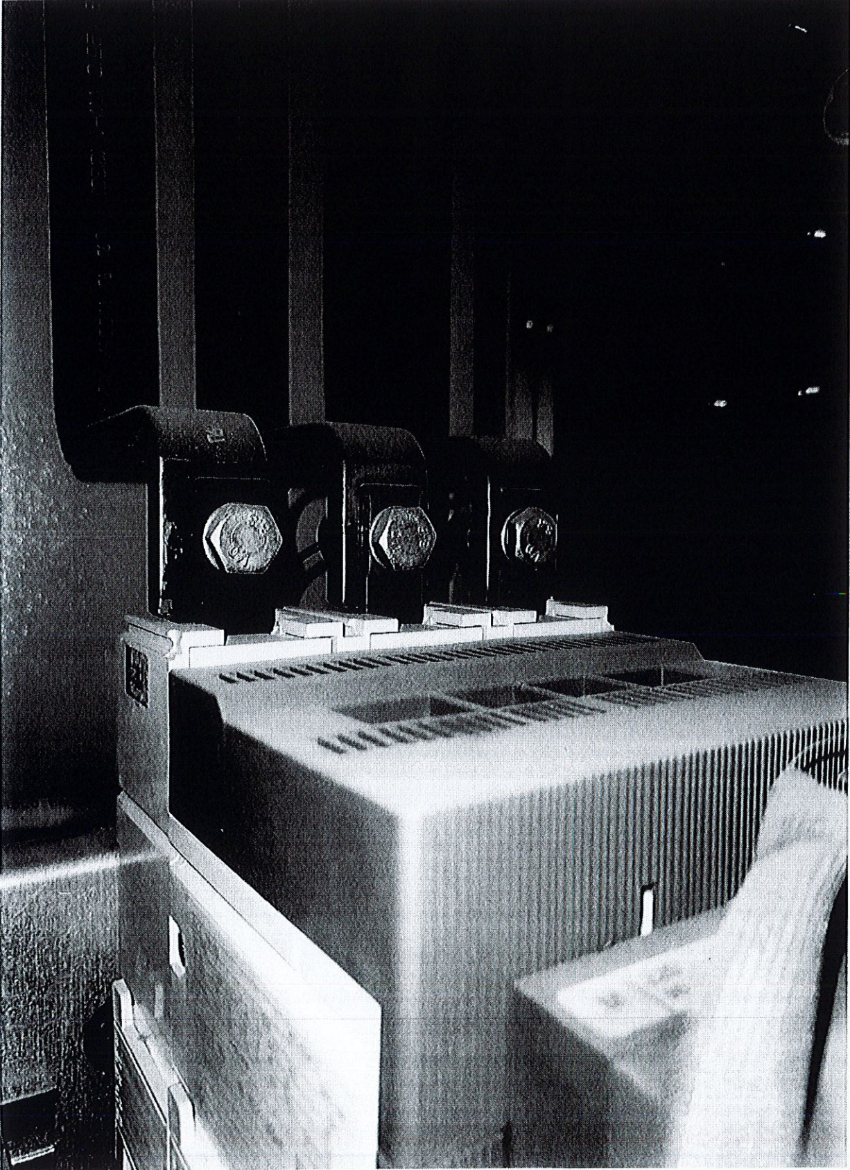
Resim 4 Mevcut Düzen Bakır Bara Bağlantı Ara Aparatları
